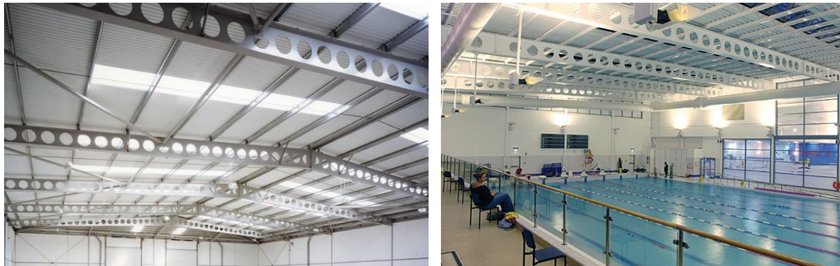
Figura 15 – Cabines DIY Preston (21 m) e Piscina Fulham Broadway (26,5 m). (fonte: www.westok.co.uk – acessado em 11/05/2011)
