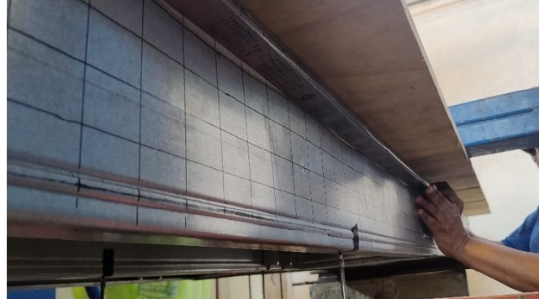
Flambagem distorcional no perfil do CP-B da laje L-2
